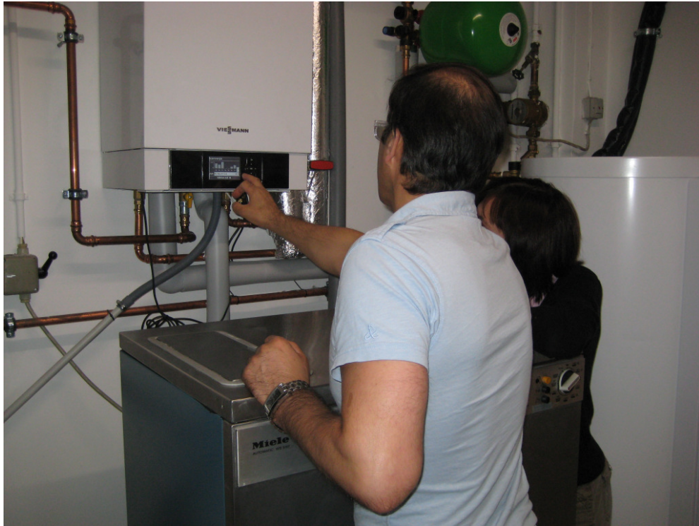
Besichtigung der Anlage nach dem Umbau, im Hintergrund der neue Solarspeicher. Foto: ZEWU mobil +
